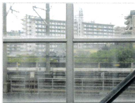
【未施工ガラス】
